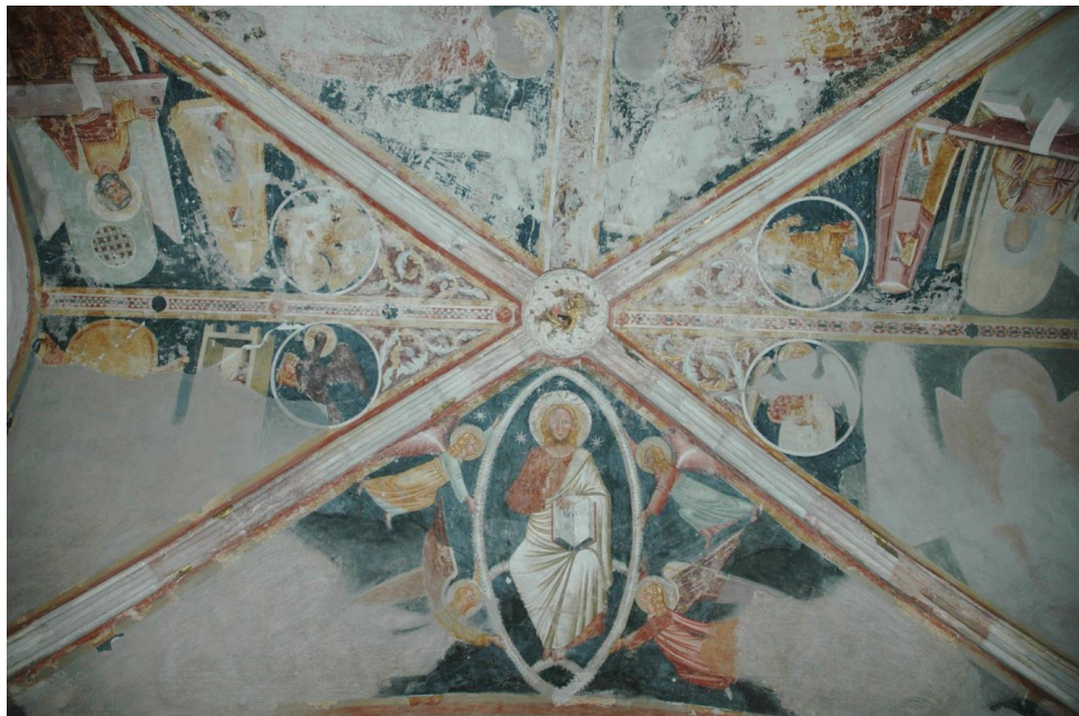
Nadbiskupski dvor, Zagreb, kapela sv. Stjepana, detalj zidnih slika na svodu; stanje nakon radova izvedenih između 2005. i 2009. godine (snimio I. Srša, 2009.)
