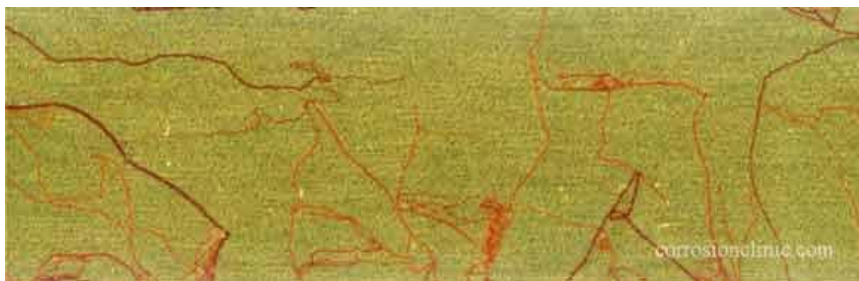
Slika 64. Izgled nitaste korozije na čeliku ispod kositrene prevlake.
