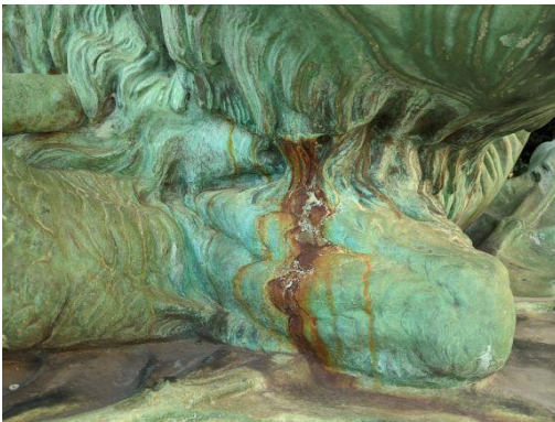
Slika 40. Najčešći slučaj kontaktne korozije kod spajanja dvaju metala (čelična nosiva konstrukcija i bronca skulpture) Čelik će zbog negativnijeg redoks potencijala ubrzano korodirati .
