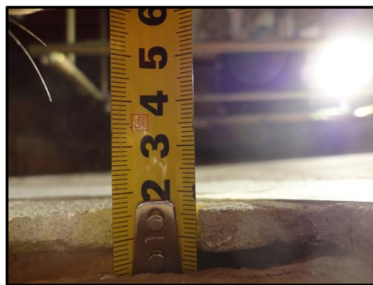
Slika 4. Mjesto uklonjene naknadne žbuke, razmak između nosioca i žbuknog sloja
